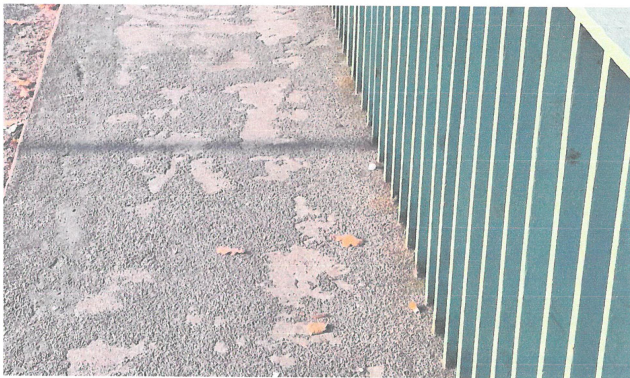
Fot. 5. Zanieczyszczenia betonu i wegetacja roślin na kapie, pęknięcia i ubytki nawierzchni chodnika - błędy wykonawcze, brak prac utrzymaniowych
