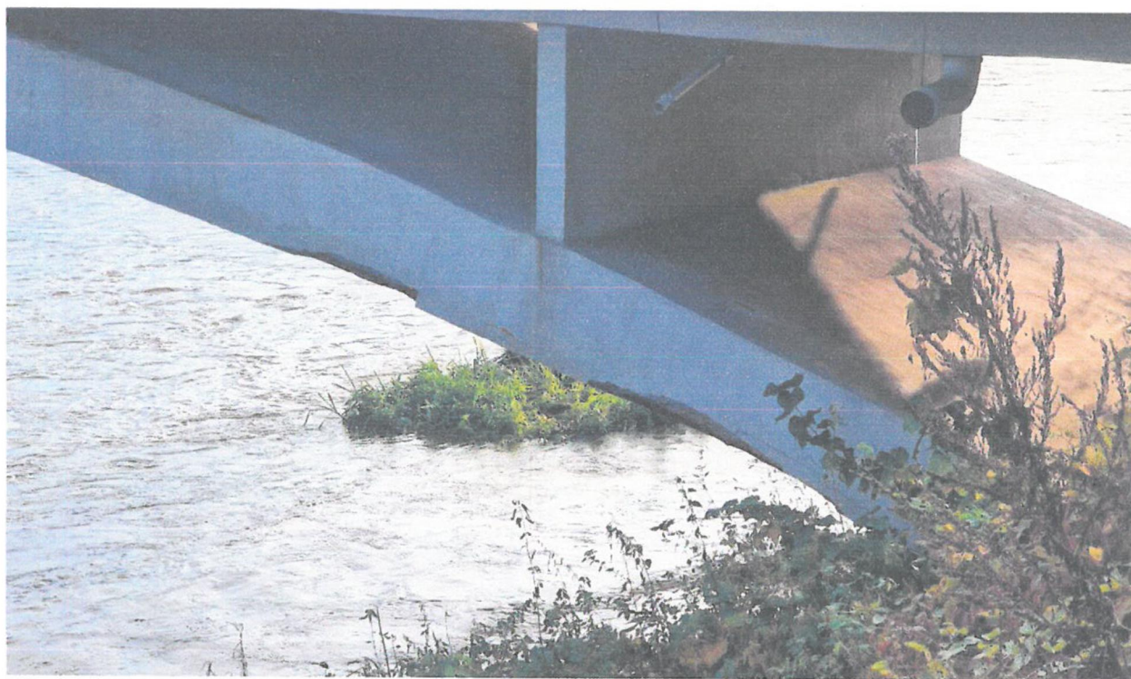
Fot. 19. Odpadające otynkowanie łuku oraz ubytki otuliny betonu z korozją zbrojenia – brak prac naprawczych i utrzymaniowych, brak prac naprawczych, degradacja materiału,
