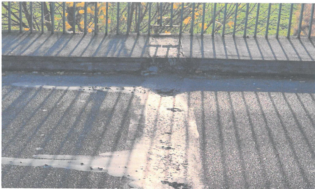
Fot. 6. Bardzo duże deformacje i ubytki dylatacji w obrębie jezdni i chodnika, - błędy wykonawcze, niedostateczne prace utrzymaniowe, wyeksploatowanie elementu
