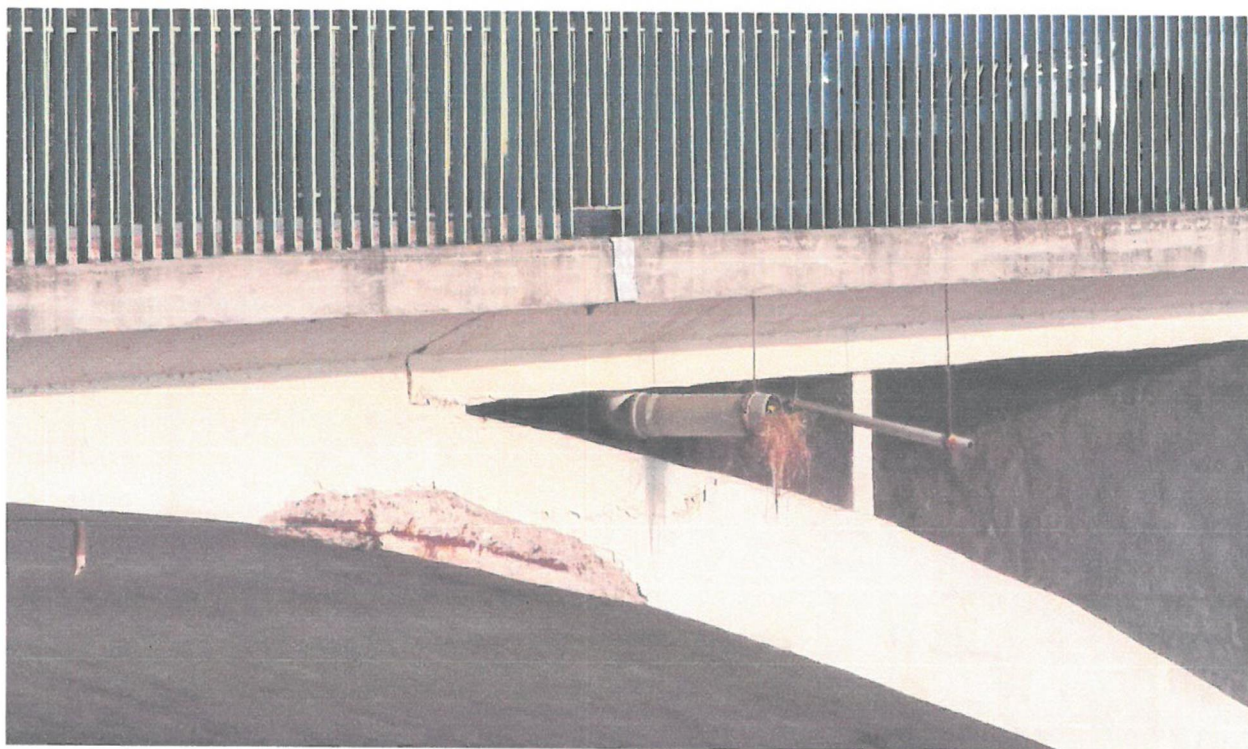
Fot. 13. Ubytki otuliny i korozja zbrojenia łuku, całkowicie niedrożne odwodnienie obiektu – brak prac naprawczych i utrzymaniowych, erozja materiału
