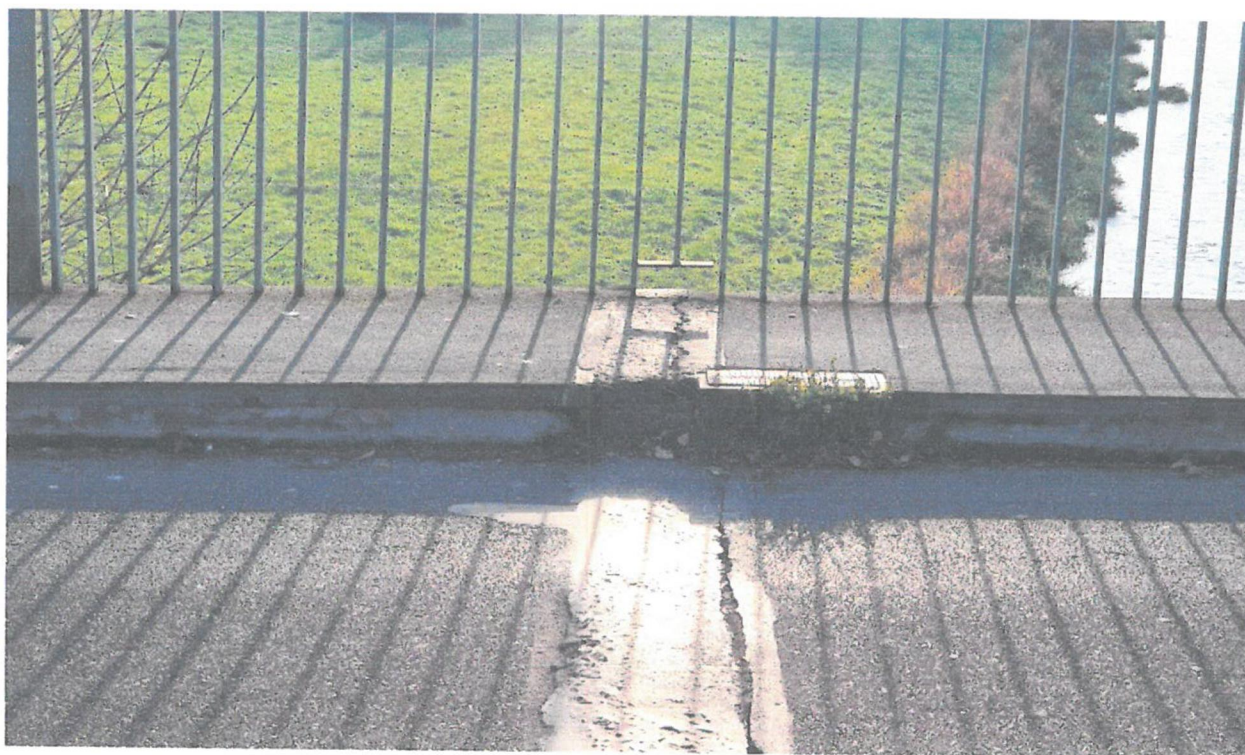
Fot. 9. Bardzo duże deformacje i ubytki dylatacji w obrębie jezdni i chodnika, całkowita niedrożność wpustu odwodnienia i wegetująca w nim roślinność, – błędy wykonawcze, niedostateczne prace utrzymaniowe, wyeksploatowanie elementu
