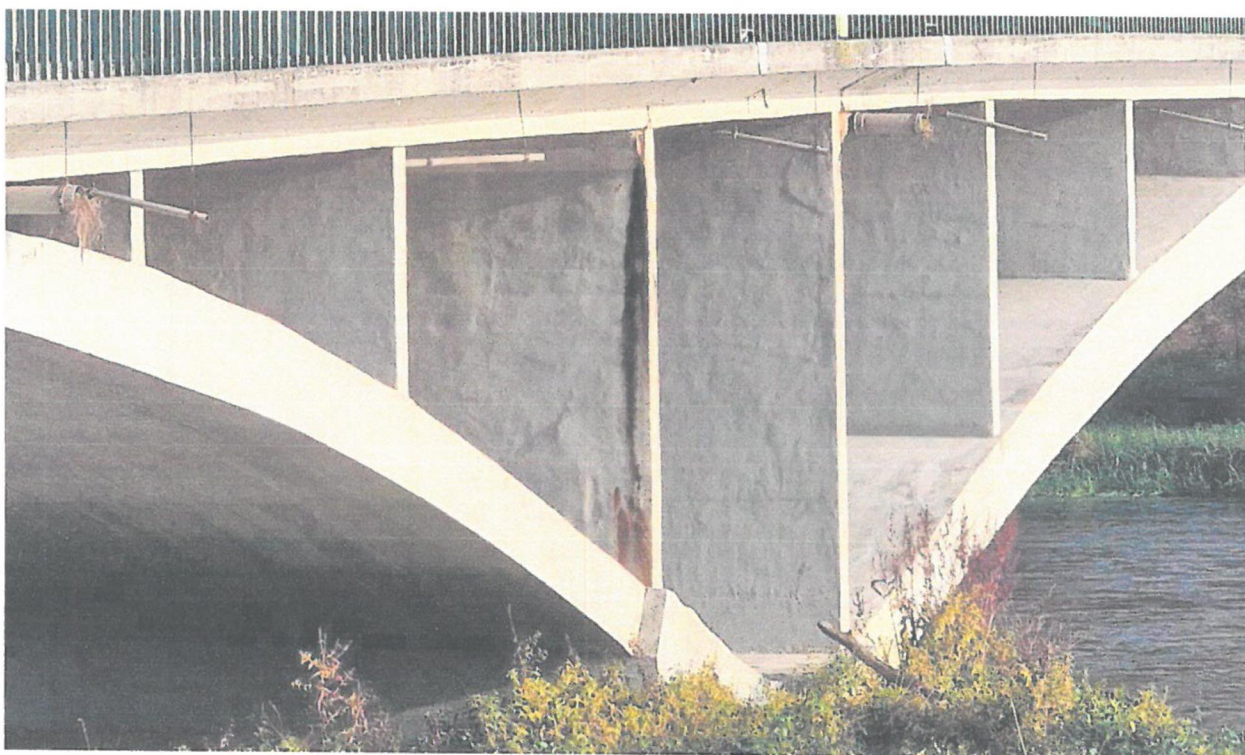
Fot. 18. Nieszczelność dylatacji i zacieki w strefie oparc przęseł zawieszonych, widoczne zacieki na konstrukcji słupków wsporczych
