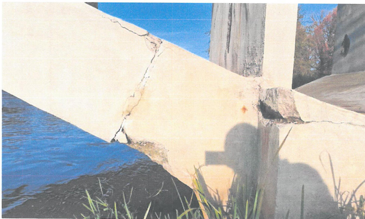
Fot. 16. Widoczna korozja betonu i jego ubytki w wezglowiu łuku oraz w korpusie podpory
