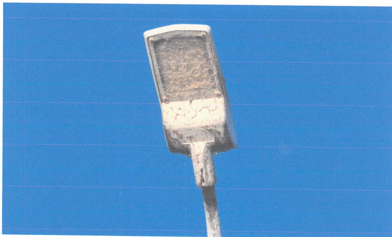
Fot. 22. Znaczne zanieczyszczenia latarni oświetlenia, korozja słupów latarni
