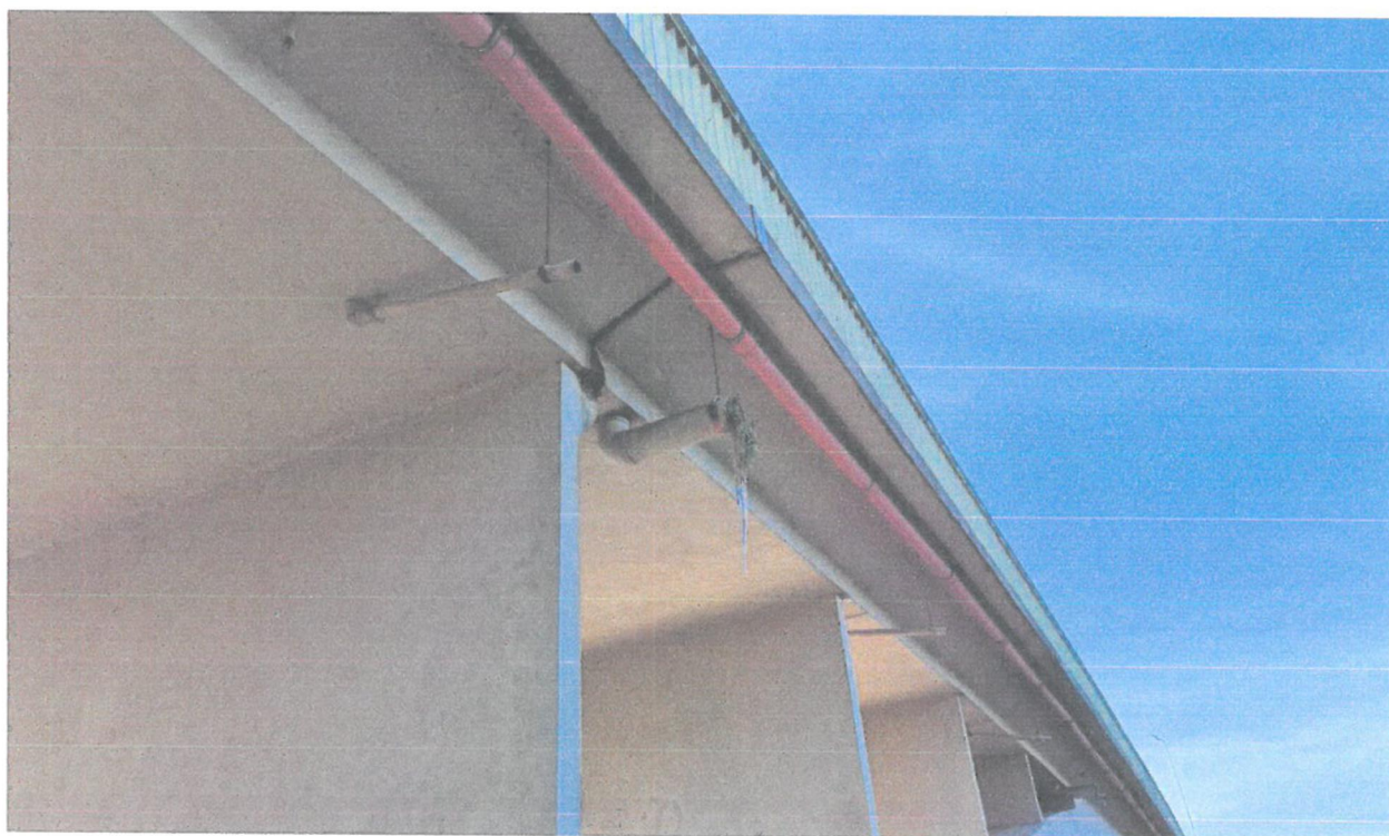
Fot. 20. Niedrożne odwodnienie obiektu, groźne zamarzanie wody w elementach odwodnienia – brak prac naprawczych i utrzymaniowych, erozja materiału,
