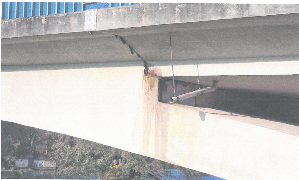
Fot. 14. Nieszczelność dylatacji i zacieki w strefie oparc przęseł zawieszonych, widoczna korozja betonu i jego ubytki – brak prac naprawczych, degradacja materiału, błędy wykonawcze,
