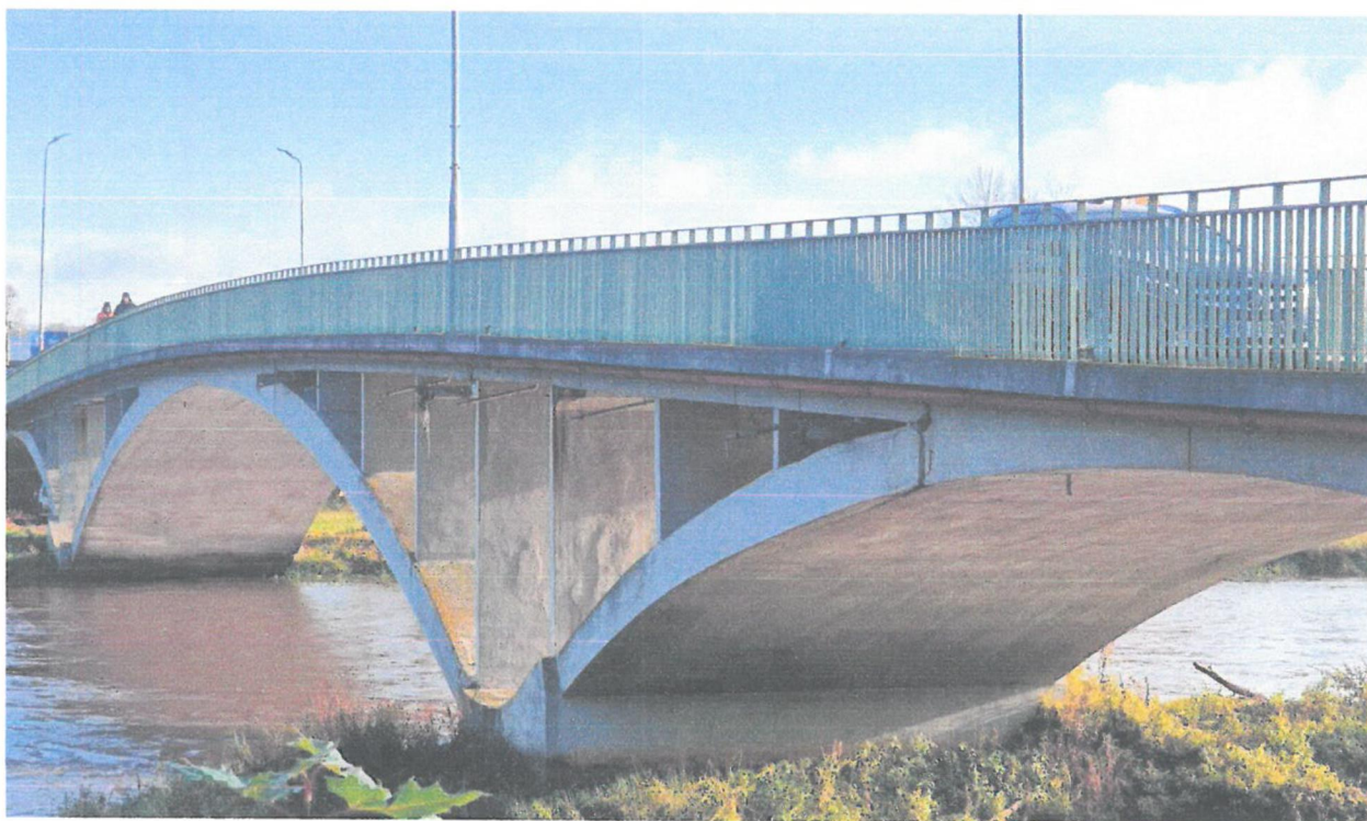
Fot. 11. Zanieczyszczenia gzymsów i elementów konstrukcji oraz zanieczyszczenia i roślinność w obrębie filara nurtowego
