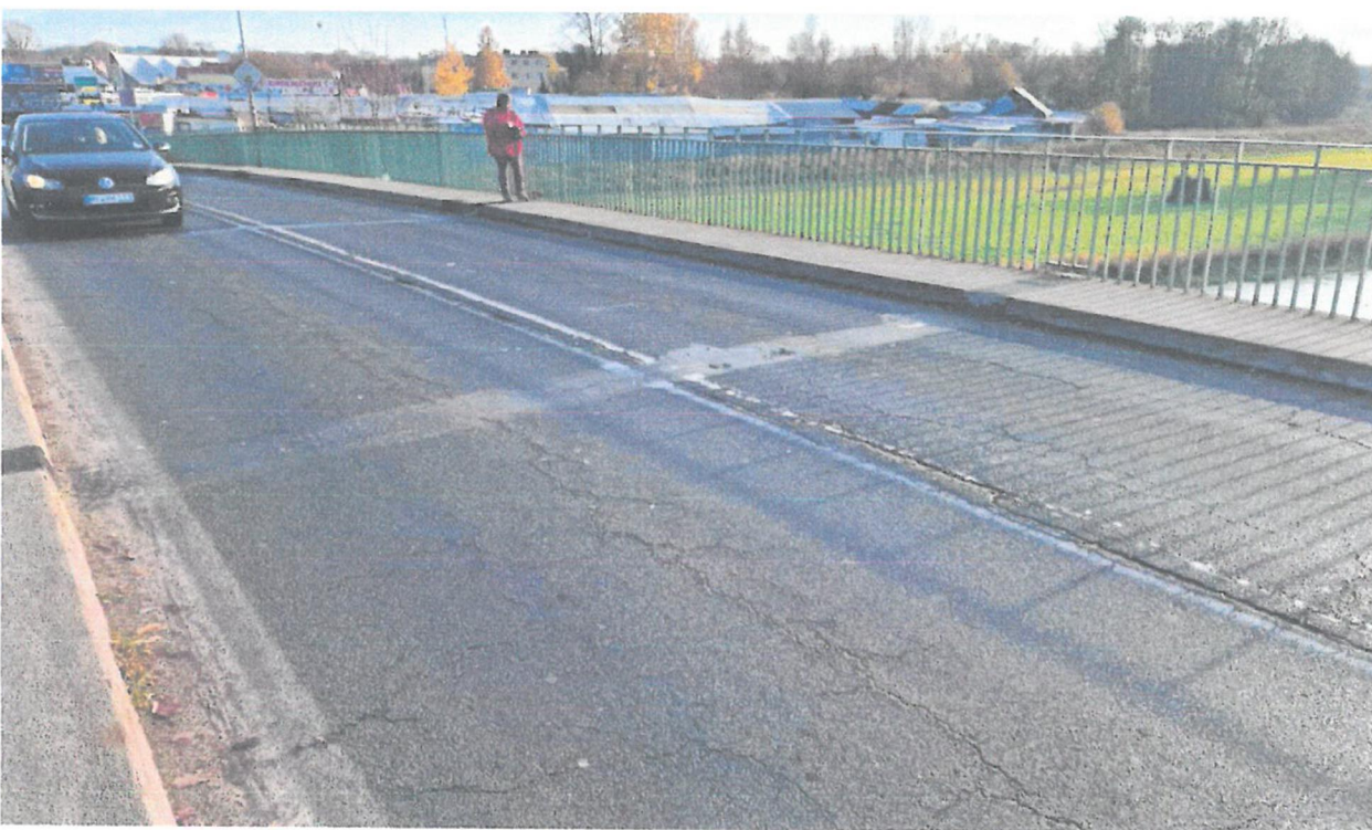
Fot. 8. Spękania siatkowe nawierzchni na obiekcie, nieszczelność przekrycia bitumicznego, deformacje i zanieczyszczenia asfaltu na obiekcie
