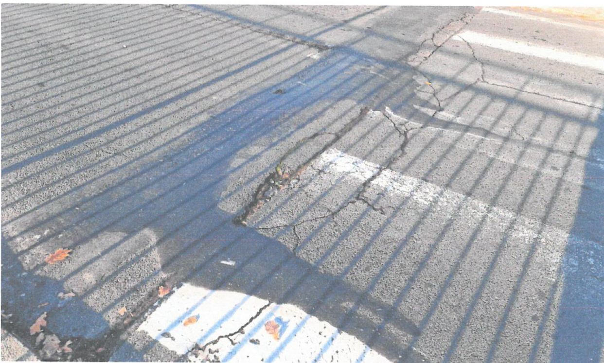
Fot. 7. Spękania siatkowe nawierzchni w obrębie dylatacji, nieszczelność przekrycia bitumicznego, deformacje asfaltu i zastoiska wody na obiekcie
