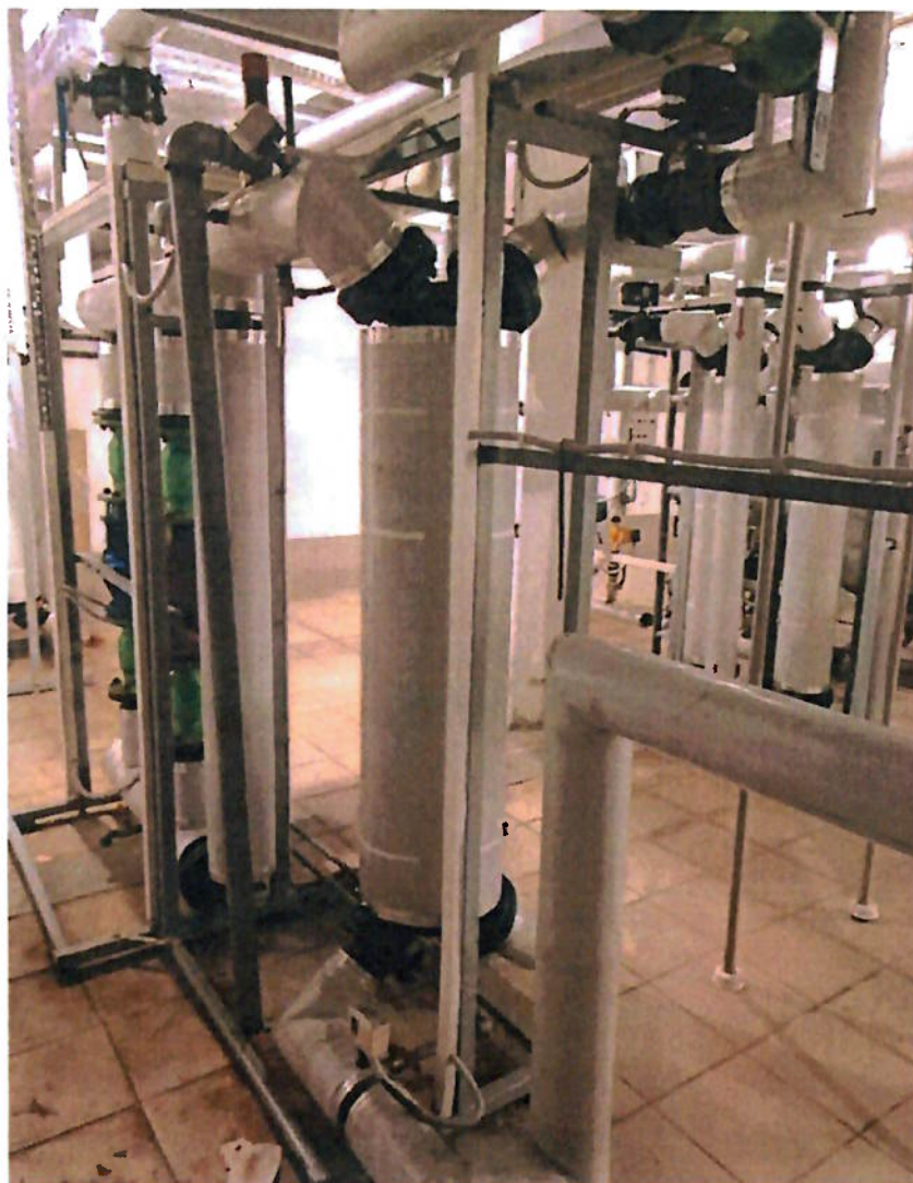
Fot. nr 2 budynek nr 42 wymiennik ciepła JAD-X
