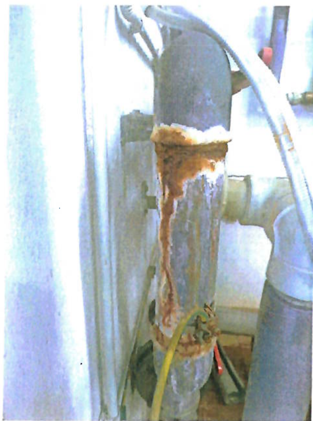
Fot. Nr 7 budynek nr 110 instalacja towarzysząca
